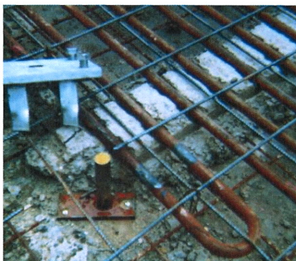
Photo 1 – Tuyau de froid appuyé sur un socle en béton pré-confectionné (photo prise lors de la construction)
